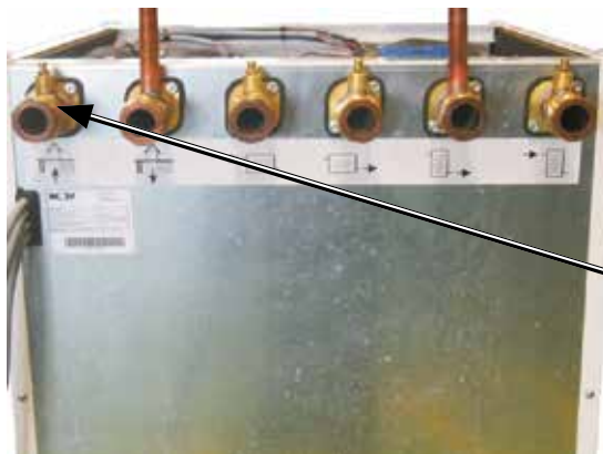
ručný odvzdušňovací ventil vo vstupe soľanky
