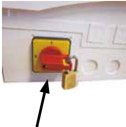
hlavný servisný vypínač
