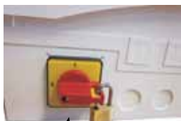
hlavný servisný vypínač
