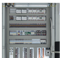
4 Câblage intégral avec armoire électrique configurée pour l'appareil, régulation comprise
