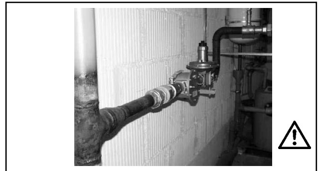
Εικόνα: Σύνδεση αερίου: Κίνδυνος δηλητηρίασης και έκρηξης λόγω διαρροής αερίου.
