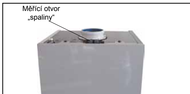
Obr. Měření spalin při otevřeném kotli
