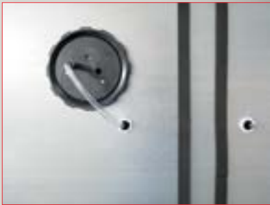
Manometerslang in de deur
