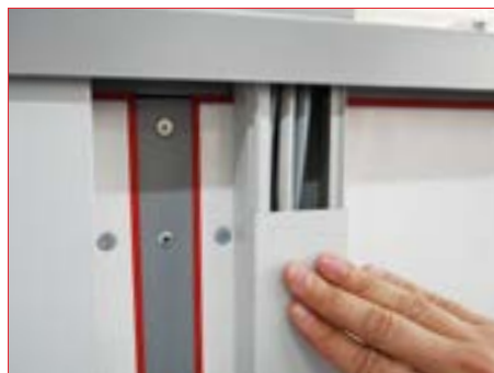
Een buitenunit is voorzien van een eenvoudig toegankelijke kabelgoot
