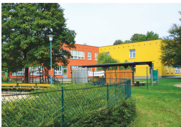
Mateřská škola Varenská ulice, Ostrava vzduchotechnické jednotky KG Top, kompaktní jednotky C Klasse
