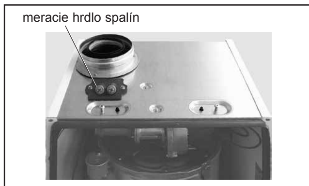
meranie spalín na kotle bez plášťa
