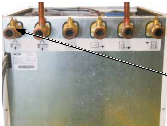
ruční odvzdušňovací ventil na vstupu solanky
