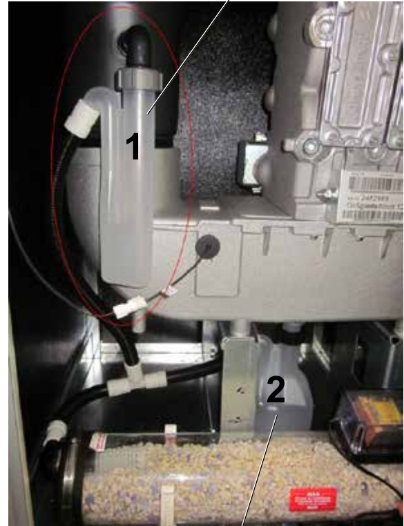
Σιφώνιο στη λεκάνη συμπτκνώματος
