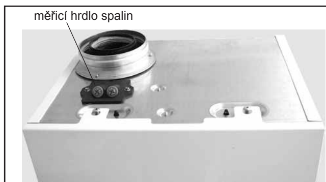
měření spalin na kotli s opláštěním
