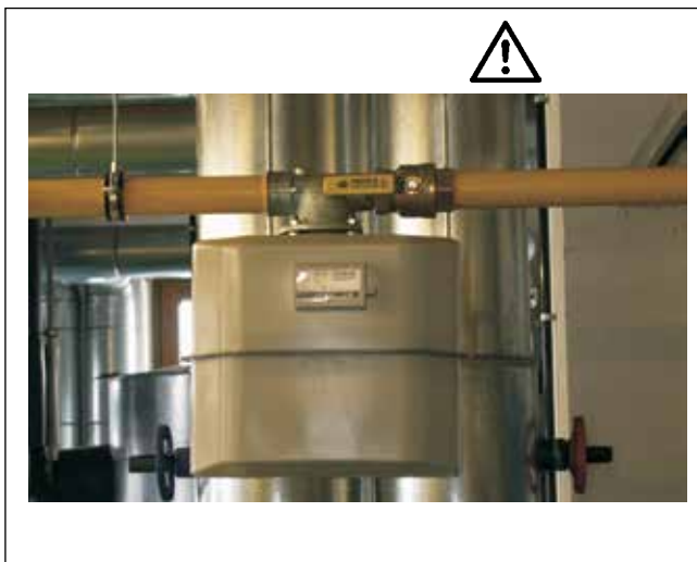
plynová přípojka: Nebezpečí otravy a výbuchu unikajícím plynem.
