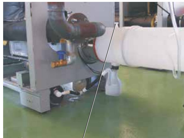
měřící hrdlo na lapači kondenzátu
