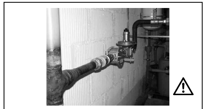
Figura: Conexión de gas: peligro de intoxicación y de explosión por escape de gas.
