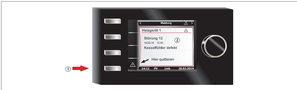
Εικ. 11.2 Μήνυμα βλάβης στη μονάδα χειρισμού BM-2
