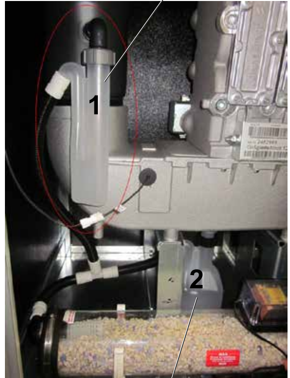
Sifón en la bandeja de recogida de condensados
