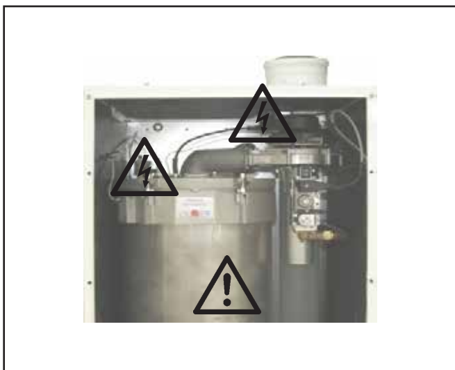
zapalovací transformátor, vysokonapěťová zapalovací elektroda, výměník tepla Nebezpečí úrazu elektrickým proudem. Nebezpečí popálení při dotyku horkých částí.
