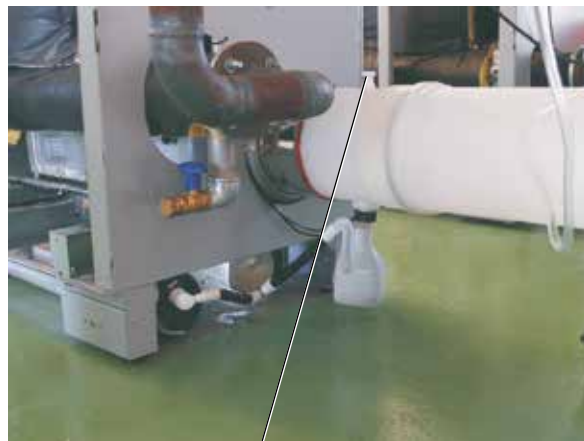
Presa di misura sullo scarico condensa
