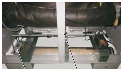
Impianto di scarico della condensa
