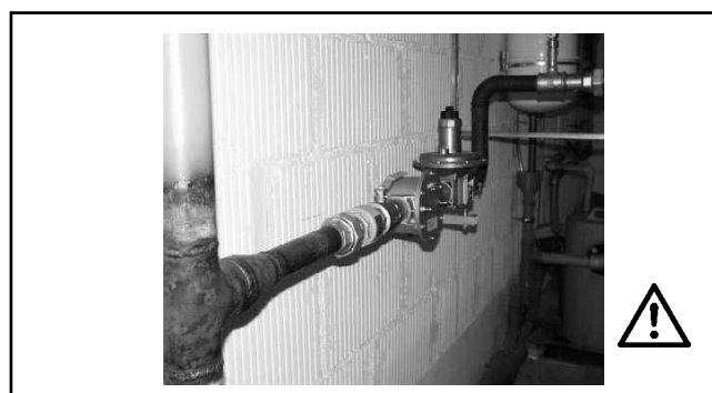
plynová přípojka: Nebezpečí otravy a výbuchu unikajícím plynem.
