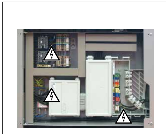
Riadiaca skrinka Nebezpečenstvo úrazu elektrickým prúdom!
